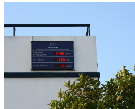
Fig. 13 bis. Display digital capaz de resistir condiciones de intemperie, que muestra en tiempo real los valores de energía, potencia e irradiancia correspondientes a una instalación fotovoltaica conectada a red. La comparación del valor de la energía neta producida y la teóricamente predecible bajo condiciones ideales permite conocer el factor de funcionamiento de la instalación.
